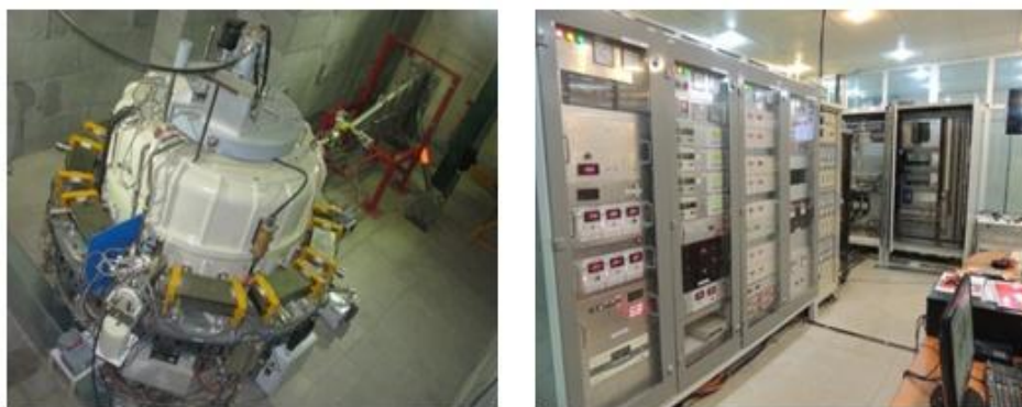
شکل ۶. شتاب‌دهنده پرقدرت صنعتی الکترون ساخته شده و بخشی از اتاق کنترل این شتاب‌دهنده.
