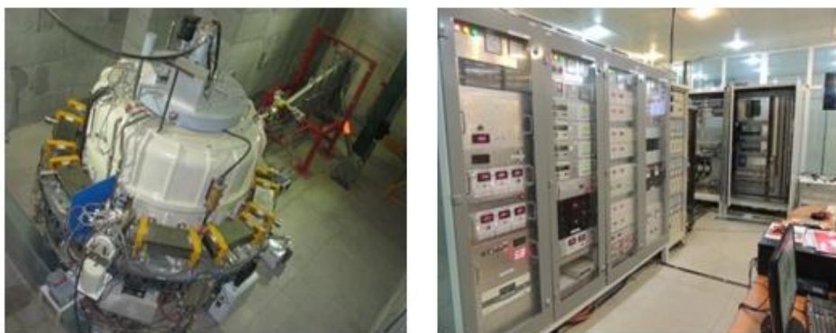
شکل ۶. شتاب‌دهنده پرقدرت صنعتی الکترون ساخته شده و بخشی از اتاق کنترل این شتاب‌دهنده.
