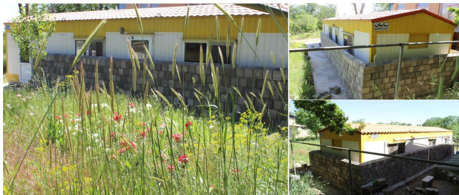
شکل ۶۴. (رنگی در نسخه الکترونیکی) دیوار آجر بتنی در حال ساخت اطراف کانکس. این دیوار در سه طرف کانکس تا سقف تکمیل شد.
